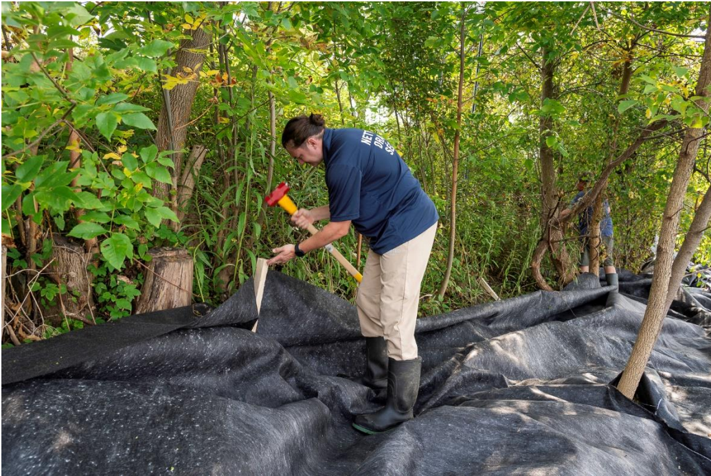
La pose de piquets en bois et en métal pour que la toile demeure en place.
