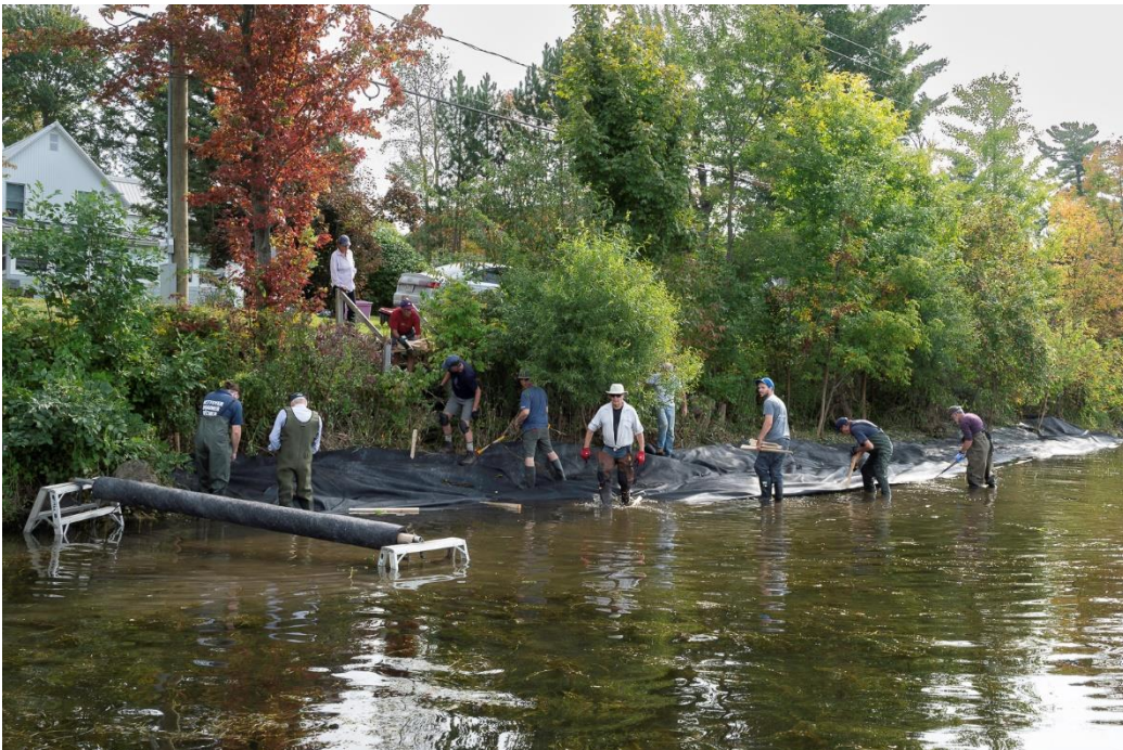
Le déploiement de la toile géotextile La zone traitée est recouverte d'une toile résistante qui prive le phragmite de lumière et empêche sa repousse.
